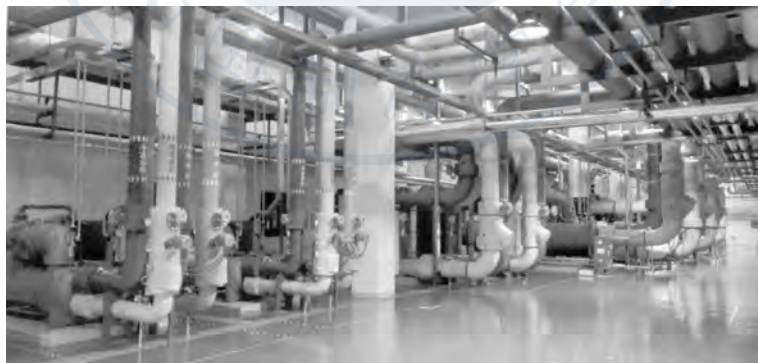
图 6.1-3 制冷站现场照片
