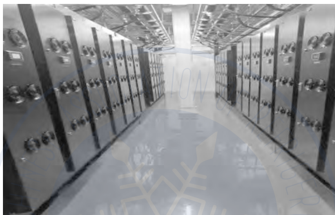
图 6.1-6 热管背板空调机房
