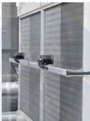
图 2.4-2 雾化装置与改造后的机组室外机
