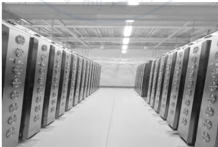
图 6.1-7 水冷前门空调机房
