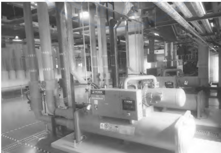
图 6.1-5 数据中心高温水源热泵
