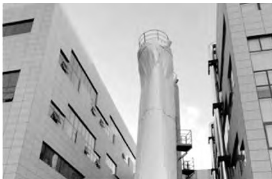
图 4.4-3 某数据中心蓄冷罐负压吸瘪
