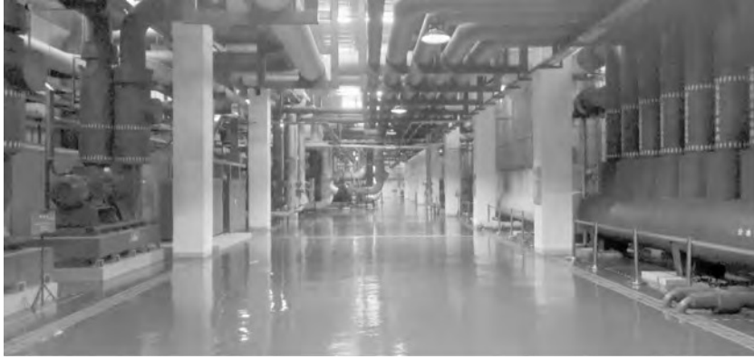
图 6.1-26 制冷站房照片
