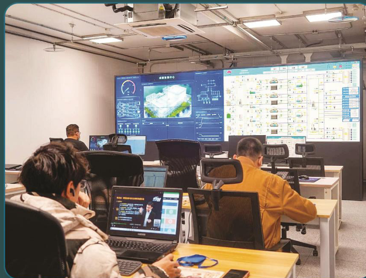
数据中心管控平台实景监控中心
