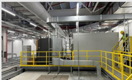
喷漆固化段 - 油漆固化冷热联用
