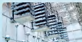
锡盟--泰州 \pm 800\text{kV}/10000\text{MW} 特高压直流/输电工程/锡盟站换流阀
