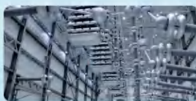
昌吉--古泉 \pm 1100\text{kV}/12000\text{MW} 特高压直流/输电工程/古泉站换流阀
