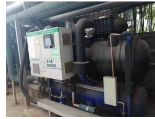
图 52 安装的磁悬浮冷水机组
