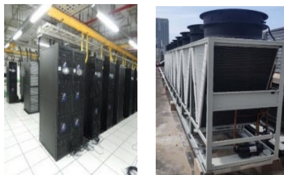
(a) 氟泵空调室内机 (b) 氟泵空调室外机 图 2 高效全变频气动热管-氟泵列间空调运用案例
