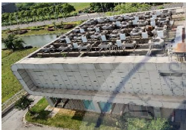
图 11 数据中心整体图
