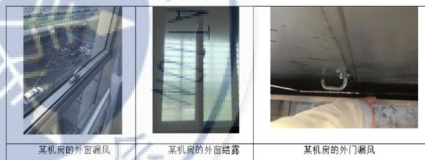
图 60 机房现场无组织漏风现象
