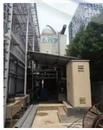
图 51 安装的冷却塔
