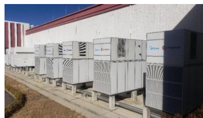
(b) 直接蒸发冷却模块化机组
