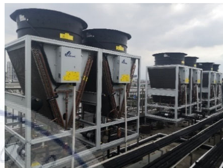
图 1 模块化气动热管-氟泵空调机组运用案例
