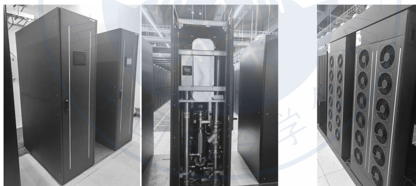
(a) 液冷CDU现场图片
