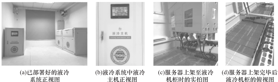
图 10.2-2 液冷系统现场部署情况
