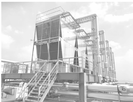
图 8.5-4 露点型间接蒸发冷却塔
