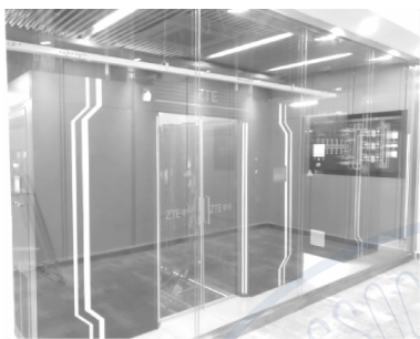
图 10.1-19 液冷机房微模块
