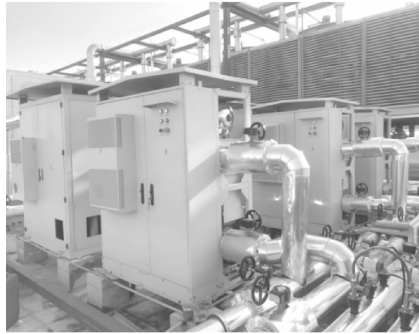
图 10.1-22 楼顶 EDU 板换模块及冷却塔
