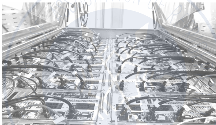
图 5.2-1 单相浸没液冷服务器面板实物图
