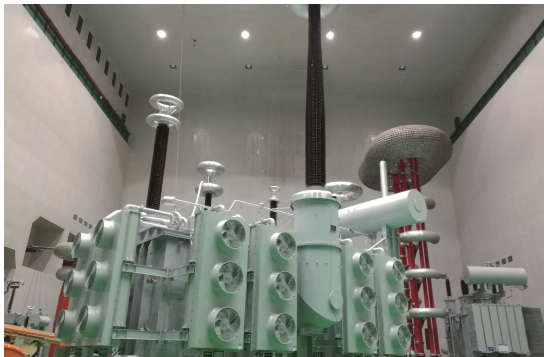
淮南 - 上海特高压工程苏州站 ODFPS-1000000/1000
