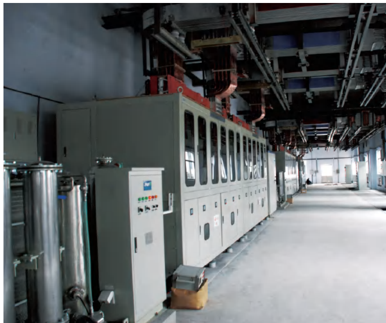
魏桥集团220kv整流器室（500ka） Weiqiao Group 220KV Rectifier Room (500KA)
