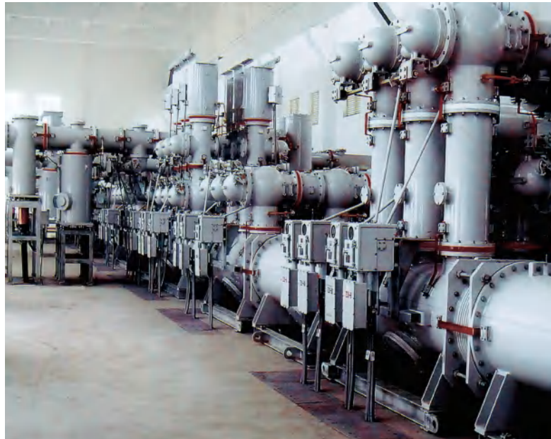
山西华泽铝电公司220kv整流所GIS系统 Shanxi Huaze Aluminum Power Co., LTD. 220KV rectifier GIS system
