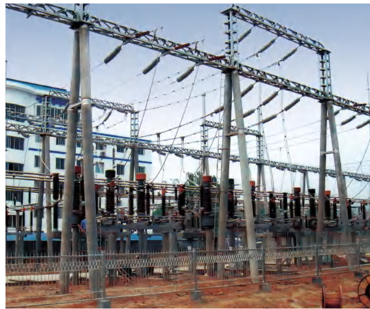
河南神火铝电集团220kv整流所 Henan Shenhua Aluminum Power Group 220KV rectifier office
