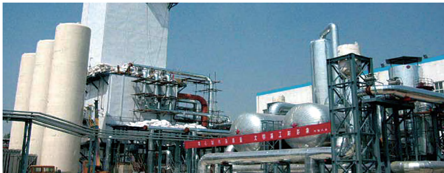
舞阳钢铁有限责任公司20000m 3 氧气站 Wuyang Iron and Steel Co., LTD. 20000M3 oxygen station
