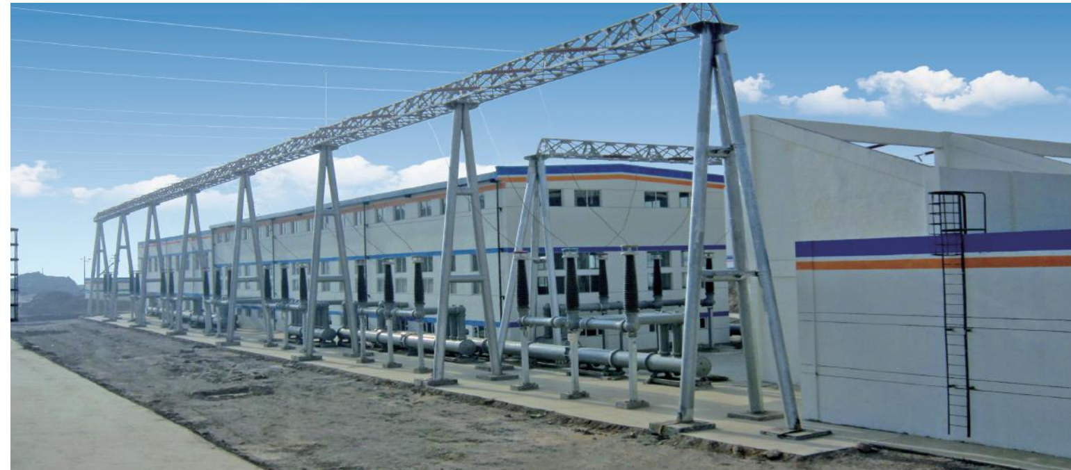
中国铝业连城分公司220kv整流所 Aluminum Corporation of China Liancheng 220KV rectifier office
