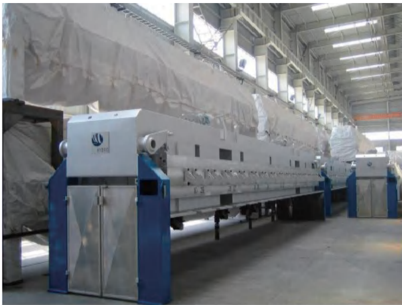
卡塔尔项目电解槽 Qatar project electrolyzer
