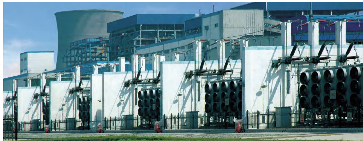
河南中孚实业股份有限公司220kv整流所 Henan Zhongfu Industrial Co., LTD. 220KV rectifier Office
