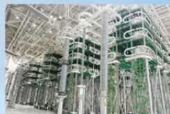
■ 白鹤滩—江苏±800kV特高压直流输电工程
