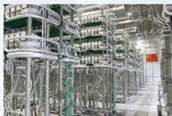
■ 江苏如东海上风电柔性直流输电工程
