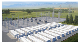
电能质量治理
