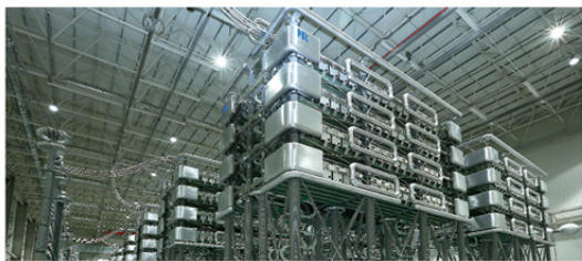
特高压柔性直流换流阀
